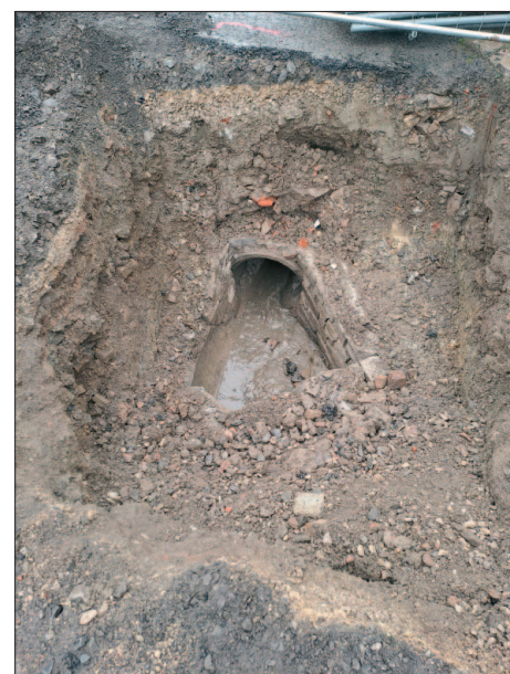
Propadlá šachta ve školní ulici.
